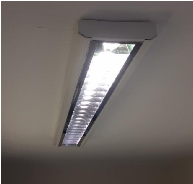
Abbildung 4: Negatives Beispiel: Spiegelrasterleuchte die starke Blendung verursacht
